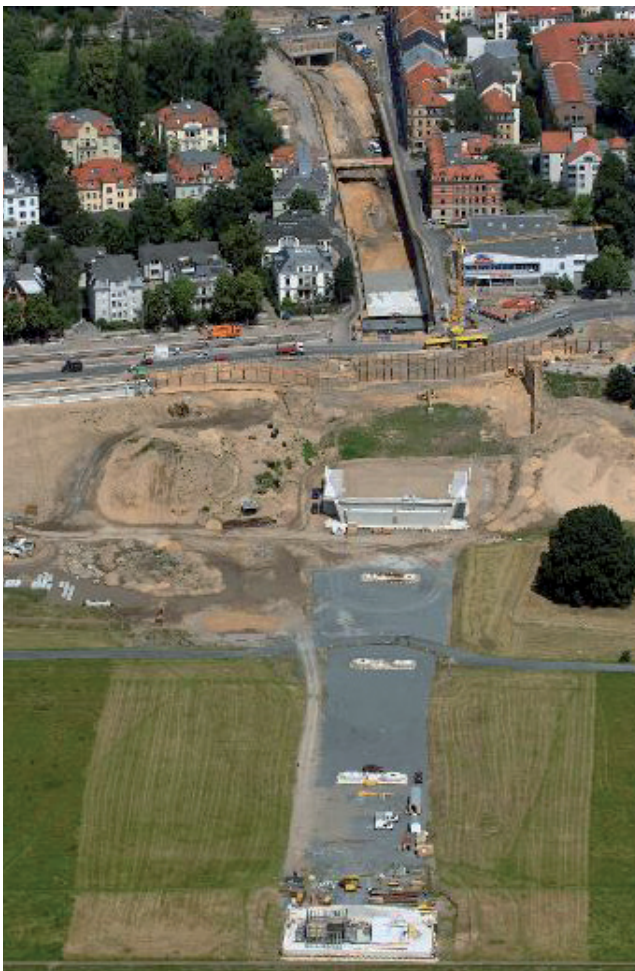
Abb. 1. Blick auf die im Bau befindliche Waldschlößchenbrücke in Dresden, aufgenommen am 17.06.2009 (dpa).
